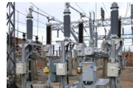
3.5.3 สวิตช์เกียร์ (Switch gear)
